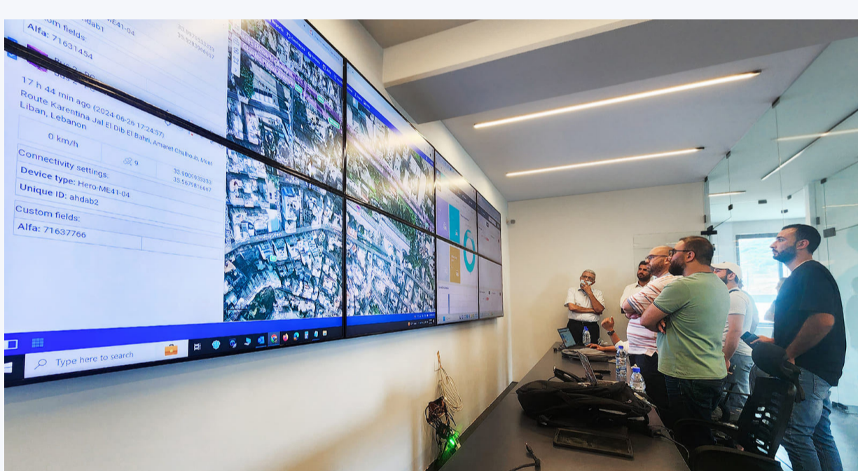
MaliaTec a fourni une salle de contrôle centralisée pour le suivi en temps réel des bus
