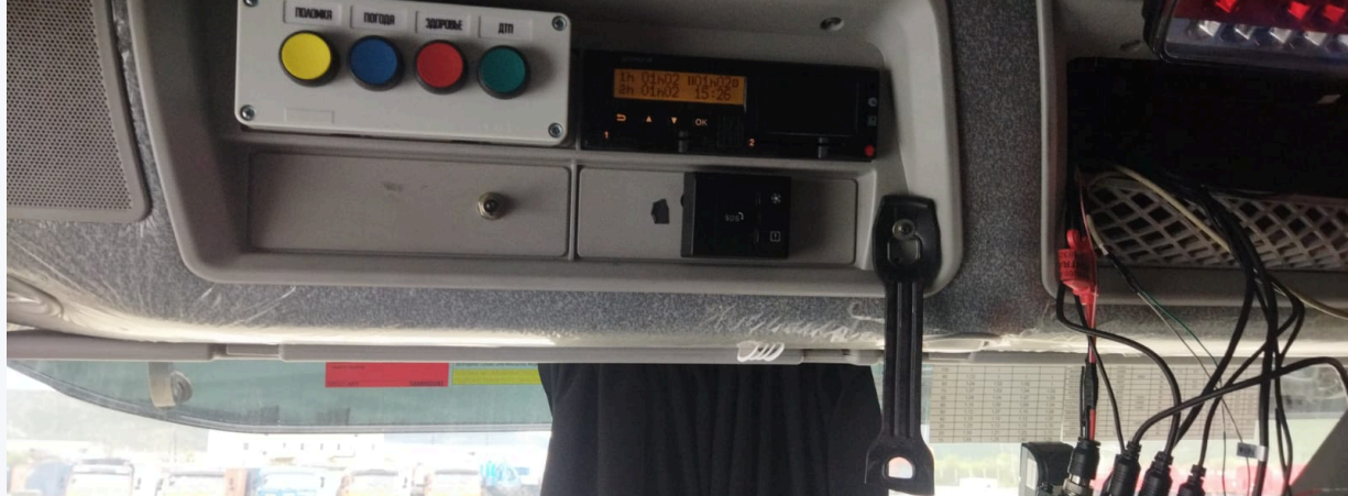
Un sistema de alerta al conductor de cuatro botones instalado en la cabina del conductor
